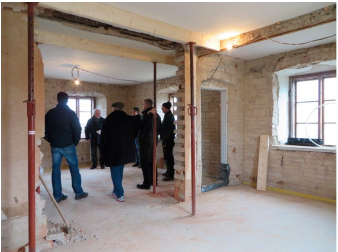
Ett nytt betongbjälklag har gjutits. Fotografi taget från rum 2106 mot rum 2104 i samband med byggmöte 2015-02-03. På bilden syns Andreas Wiström, Håkan Ekerå, Hans Wiström, Bengt Petersson, Per Sandberg och Daniel Pettersson.
