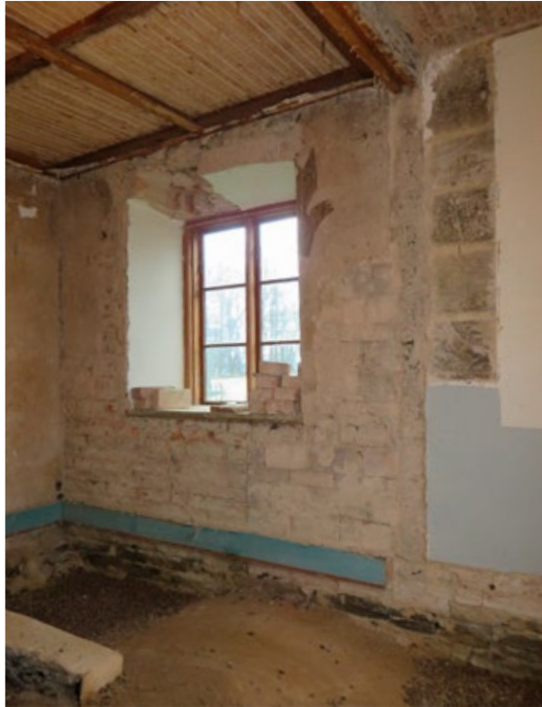
Vid besiktning 2014-12-16 upptäcktes att innerväggen mellan rum 2112 och 2111 rivits. Fotografi från rum 2112 mot den västra gavelns fönster i rum 2111. Vid golvnivå syns översidan av källarens murade valv.
