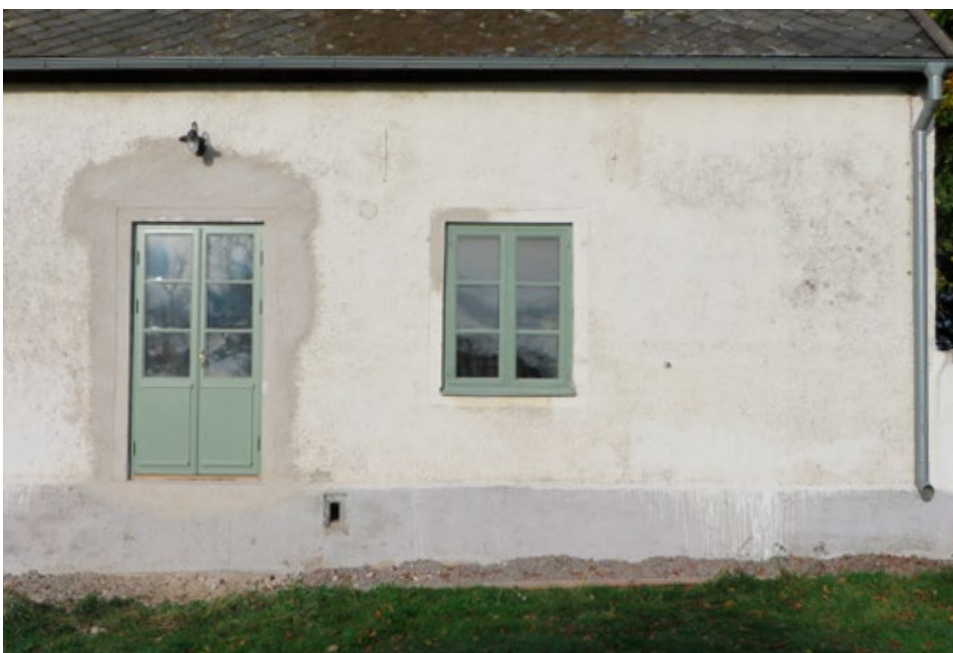
Närbild av södra fasadens östra del efter upptagning av muröppning och montering av ny altandörr. Dörren har utformats som en traditionell pardörr. Glasöppningarnas indelning är anpassad till byggnadens fönster.
