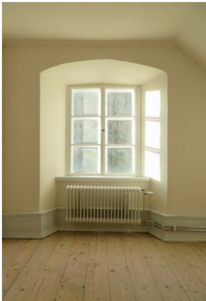
I övervåningens båda renoverade rum mot väster har de gamla fönsterbänkarna bevarats.
