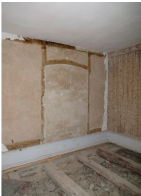
Vägg mot norr i rum 2106 före åtgärd. Under tapeterna fanns tydliga spår efter en äldre igensatt dörröppning.
