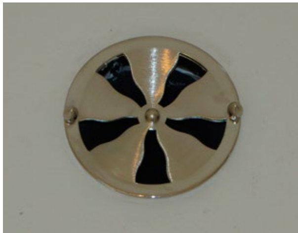
De gamla ventilationsgallren har ersatts av nya galler i samma utförande.
