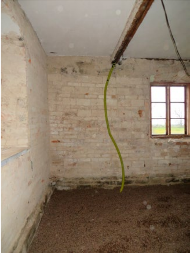
Vid besiktning 2014-12-16 upptäcktes att väggen rivits.
