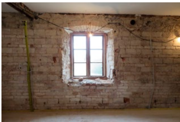
Fönsteröppning från 1870 efter rivning av invändig panel och puts. Till vänster i bild syns rester efter en riven timmervägg.
