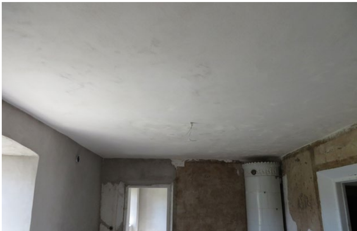
Vid byggmöte 2015-06-04 fastslogs att innertakens kalkavfärgning blivit allt för flammig. Fotografi från rum 2108.
