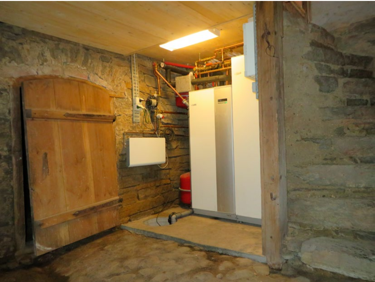
Fotografi från källaren efter installation av värmepump. Till höger i bild syns trappan upp till bottenvåningen.
