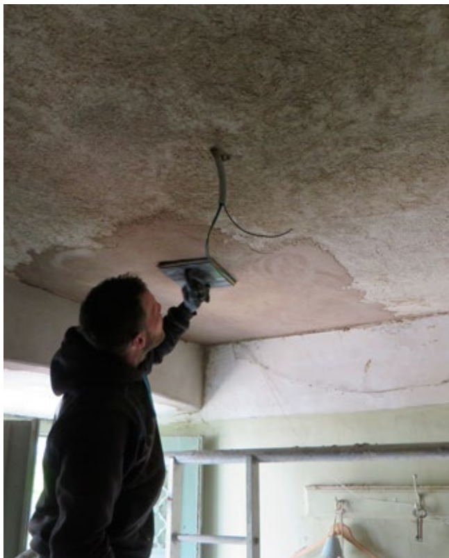
Fotografi från det möte som hölls 2015-05-20 med anledning av de nyputsade ytornas allt för grova struktur. Johan Nordström från Calmarsunds Mur & Fasad AB utförde en provyta som godkändes.
