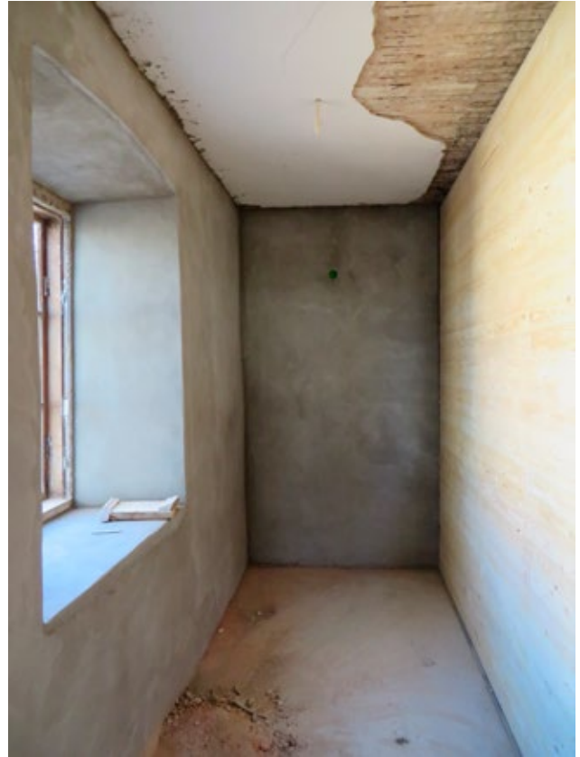
Skafferiet under pågående renovering. Väggen mot rum 2106 återuppfördes som en brädklädd och gipsad regelvägg. Jämför med bild från rum 2106 på sidan 33.
