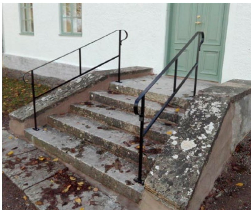
Östra entréns trappa med nya räcken i svartmålat smide. Foto: Andréas Wiström.
