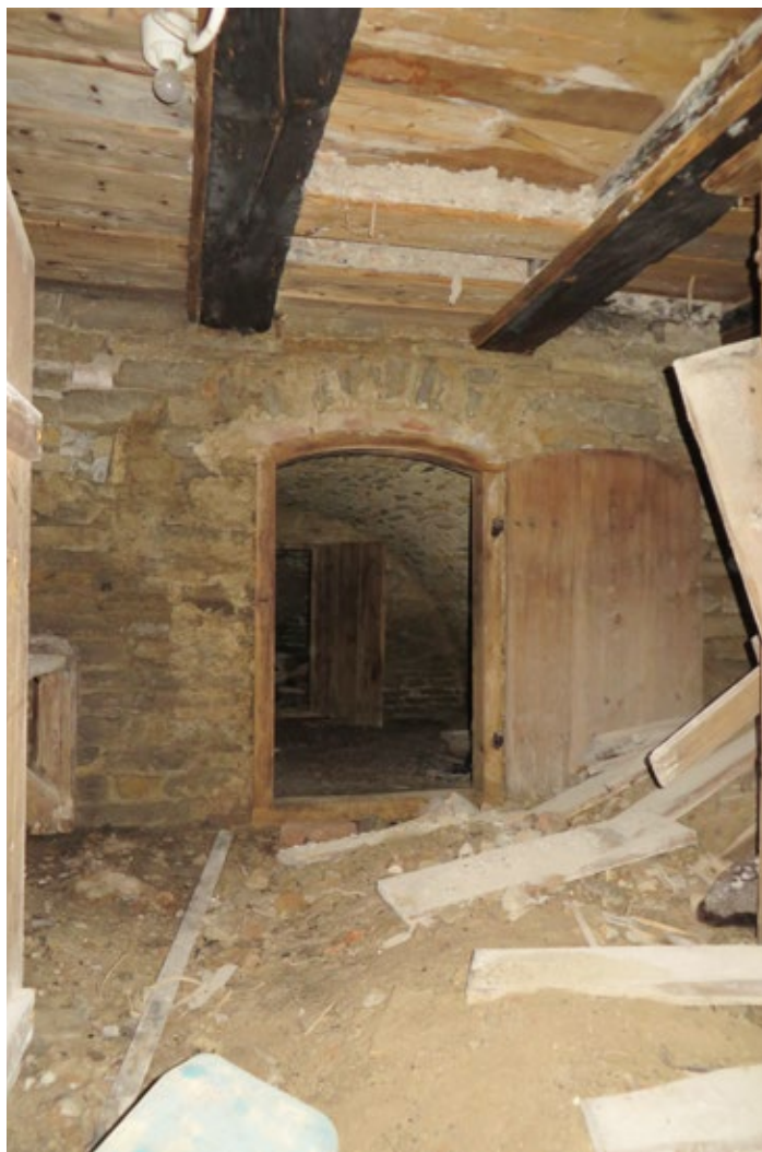
Rum med träbjälklag under västra entréns farstu. Husets värmecentral placerades i rummets inre del.
