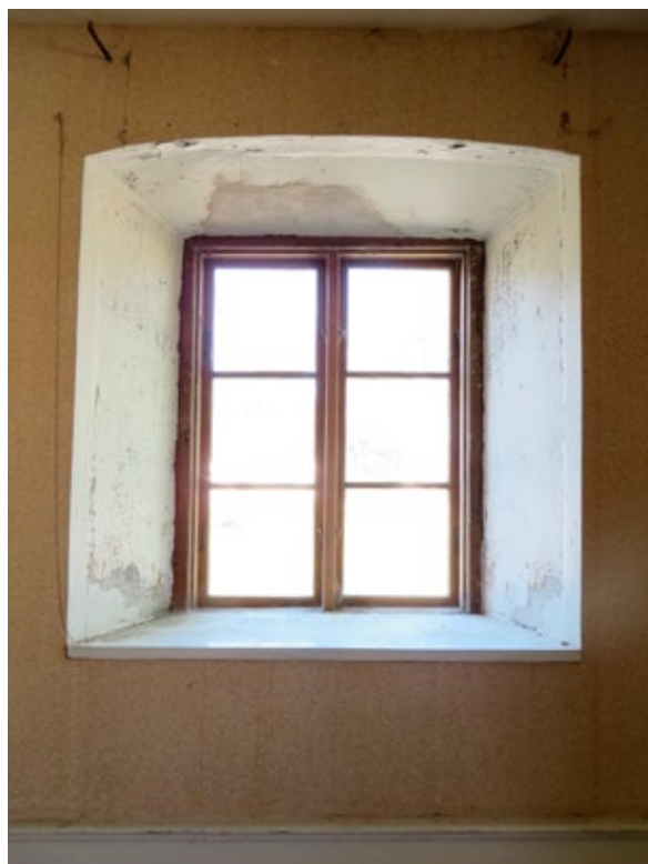
Fönster i rum 2104 före åtgärd. I denna del av huset var fönstren invändigt ådringsmålade i brunt.
