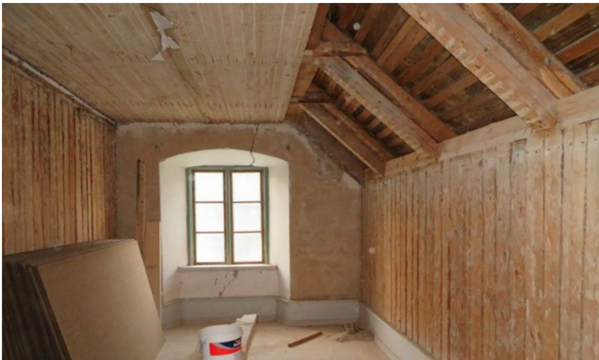
Övervåningens gavelrum mot nordväst (rum 2206) efter rivning av ytskikt. Rummets utseende före och efter renovering syns på sidorna 30 respektive 31.
