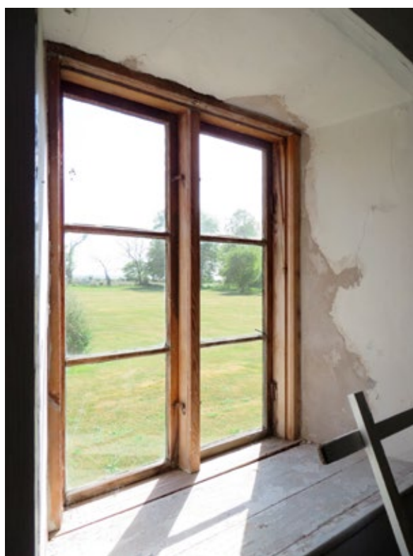
Fönster i rum 2106 före åtgärd. Samtliga fönster var sannolikt från 1870. Inga innerbågar var bevarade på plats.
